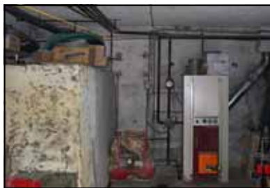
Installation de chauffage d'un particulier lors d'un contrôle effectué par ICB
